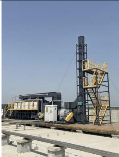
P1 有机废气排气筒
