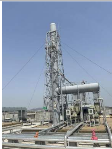
P3 酸性废气排气筒
