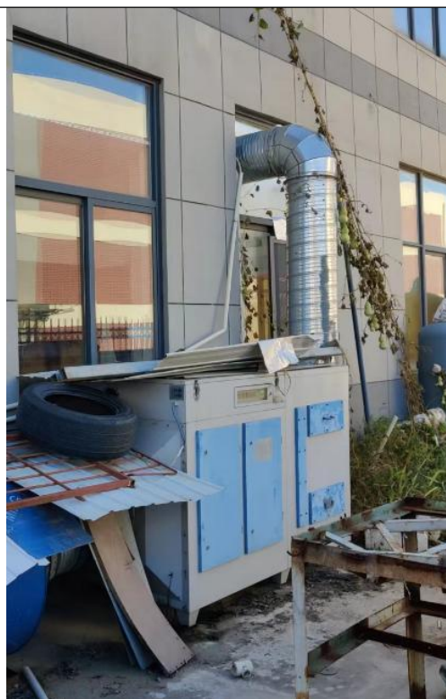
废气治理设备
